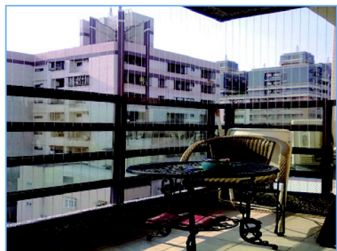
橫向欄杆且間隙超過 10 公分，幼兒易攀爬，建議加裝間隔小於 10 公分之直條防墜
