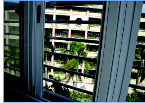
在走廊邊間處之窗戶為水平式推拉窗戶，設置橫式欄杆，且欄杆間隙小於 10 公分
